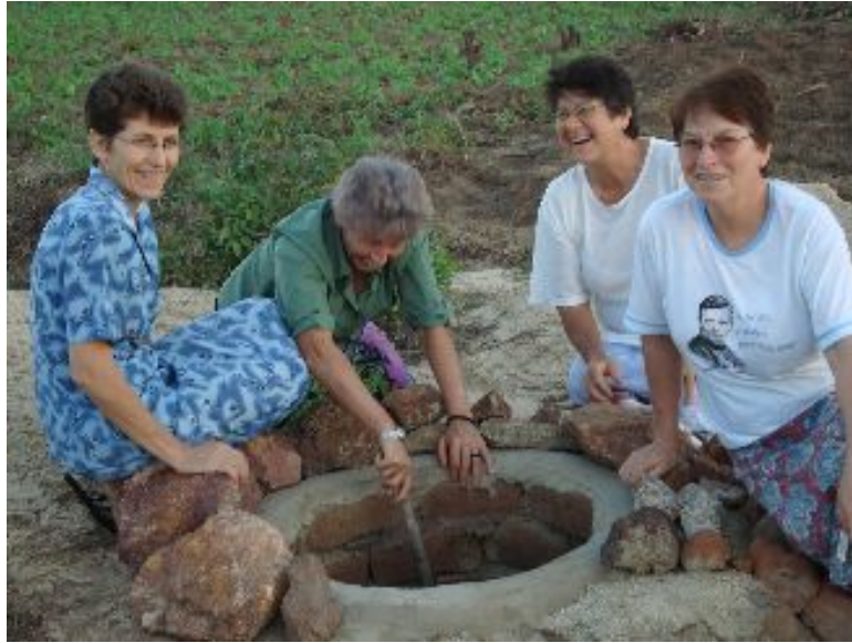
Figura 1: Poço de água
